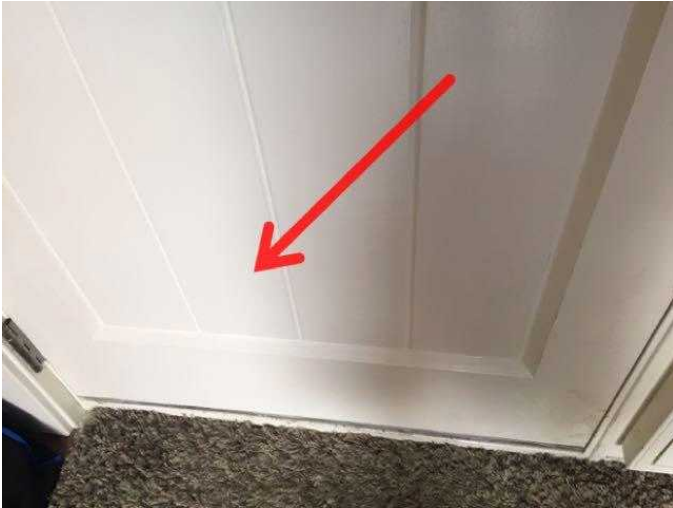
Bedroom 1: Broken door
